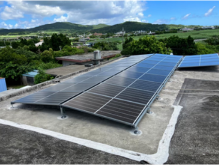
太陽光パネル
